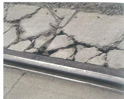
4. ábra. Pályalemezromlás az 1-es sz. villamos B, D szakaszán
